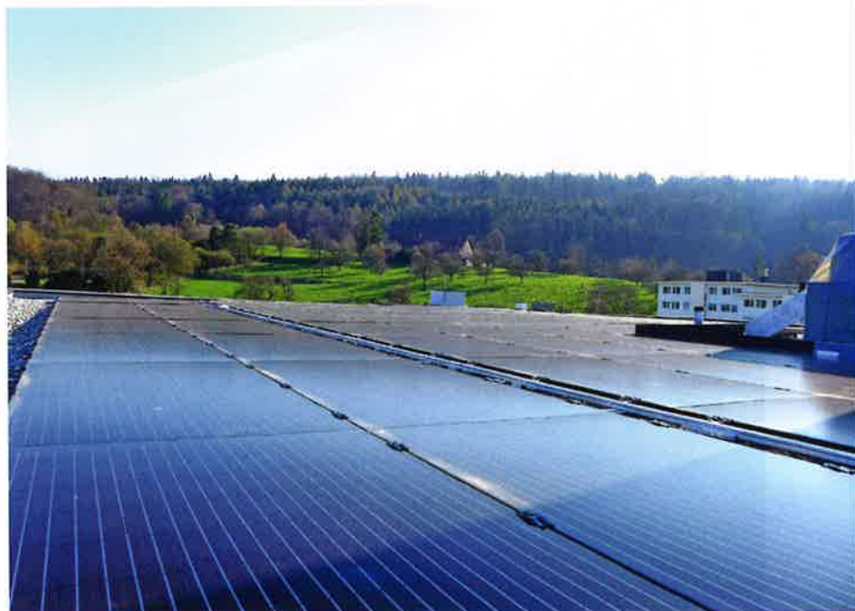
Auch auf dem Dach der Anlage befindet sich eine PV-Anlage.
