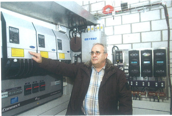
Dieter Zerfass in der Hauszentrale; hier wird die aktuelle Stromerzeugung (BHKW, Solaranlage) sowie der Strombezug abgelesen.
