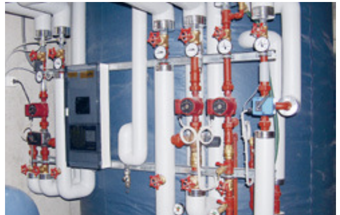
Armaturen gut zugänglich
