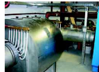
Rauchgaswärmetauscher POWERcondens bei Stalder Rail in Bussnang
