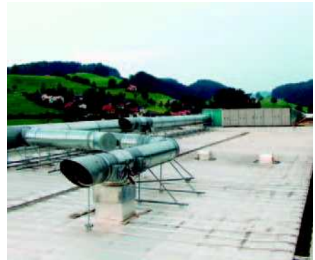
Abluftsammelkanäle mit Wärmetauschern im Hintergrund
