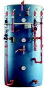
Hausstation für Nah-/Fernwärme mit Swiss Solartank
